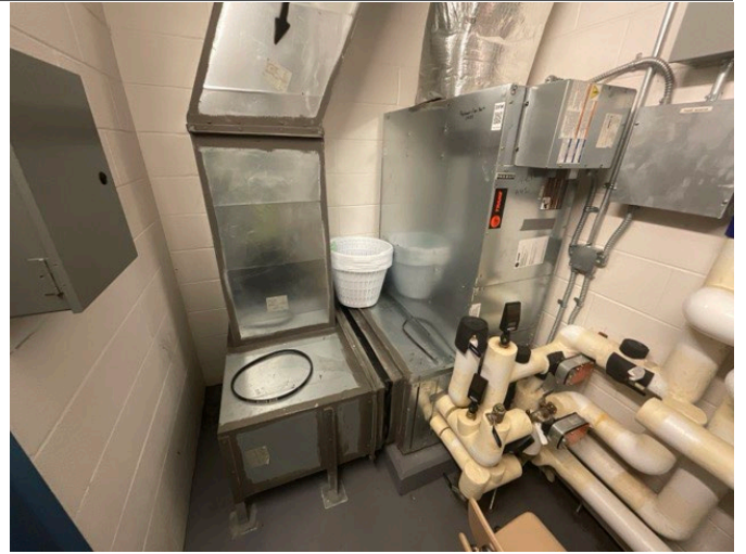
14 - FAN COIL UNIT
